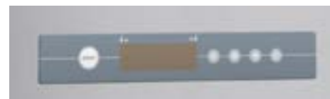
Particolare quadro comandi
